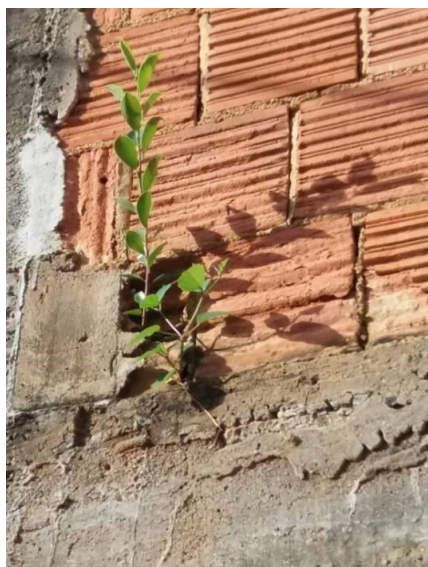
Figura 11 – Brotando entre blocos de concreto. Acervo pessoal.
